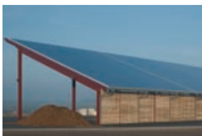
Le hangar de stockage couvre 1 700 m 2 et comprend une toiture équipée de panneaux photovoltaïques.
